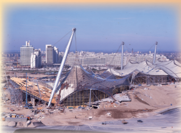
Das Olympiagelände im Bau: Im Zentrum standen die markanten Dächer für die Sportstätten.
